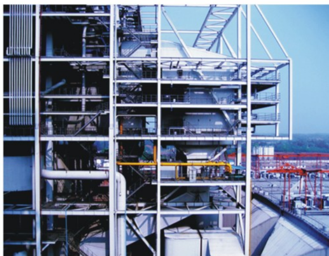
长沙电厂2×600MW机组SCR烟气脱硝项目
